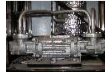
вакуумный насос газозоврата
